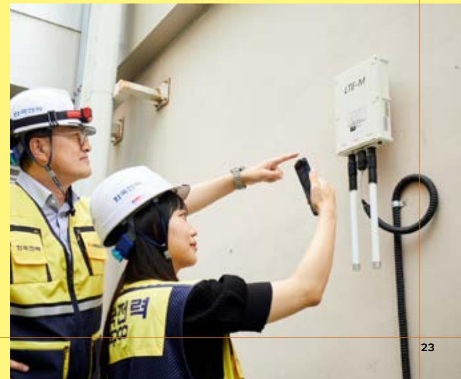
옥상에 설치된 PS-LTE 송수신기.
