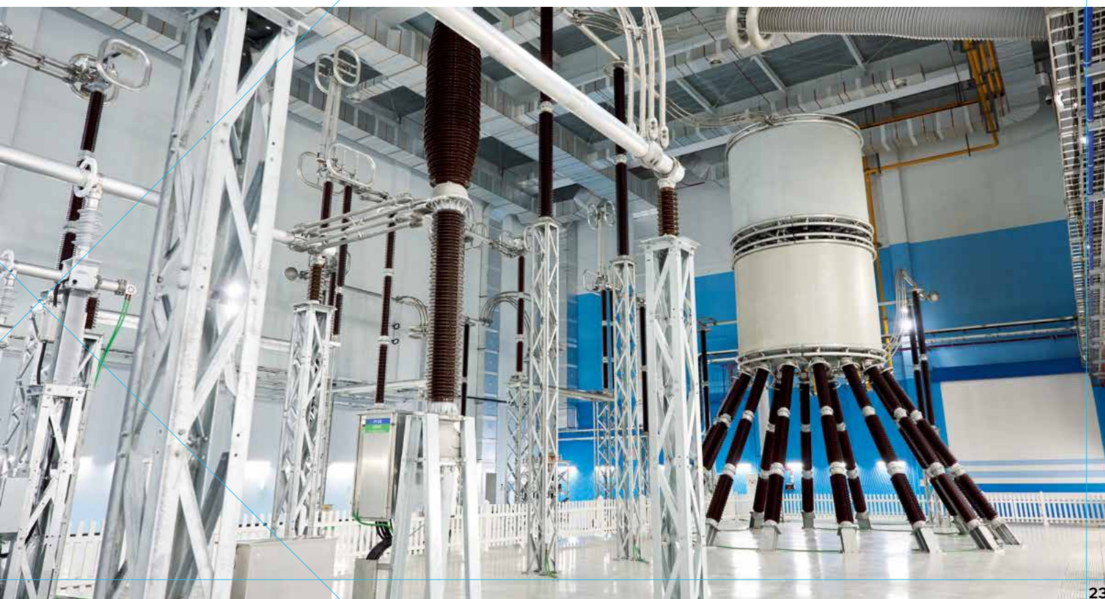
교류 성질을 없애 직류전기의 완성도를 높여주는 DC 설비.
